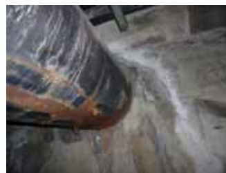
老朽化した幹線排水管
